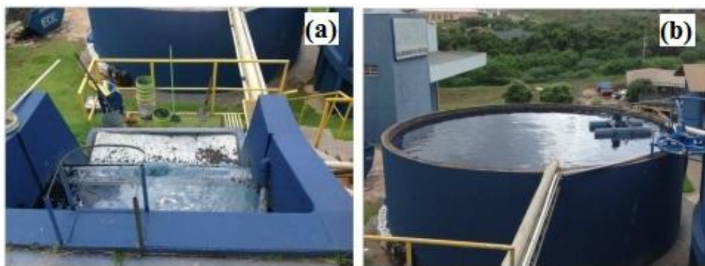
Figura 3. Característica visual do efluente gerado por uma lavanderia industrial de jeans em Maringá/PR. (a) saída do efluente pela unidade de peneiramento e (b) descarte na lagoa de estabilização/equalização.
